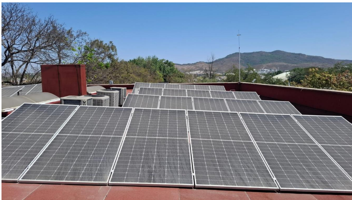
Paneles Solares Edificio LICBI
