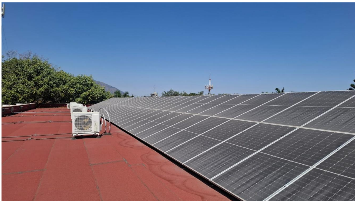
Paneles Solares Edificio CB
